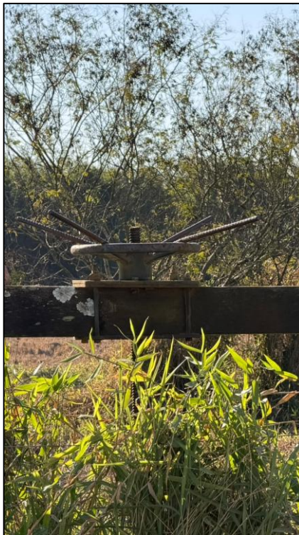
Figura 47 – Sistema manual de registros/válvulas de controle de vazão d'água
